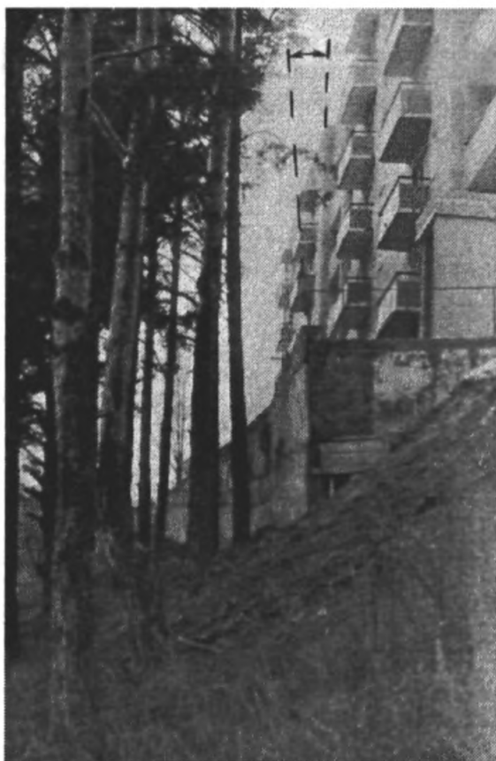
Рис. 38. Ул. Ракетная. Крен подпорной стенки.
