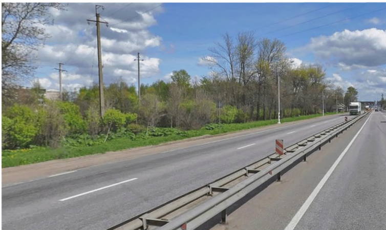
Рисунок 3 – Металлическое барьерное двустороннее дорожное ограждение на автомобильной дороге М-10 «Россия»
