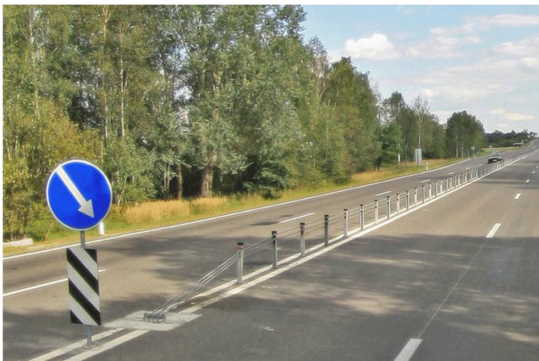
Рисунок 8 – Начальный участок тросового дорожного ограждения
