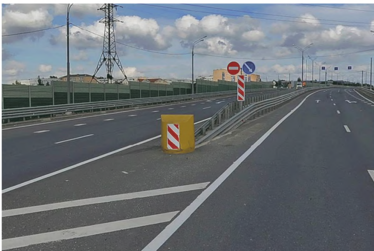
Рисунок 11 – Фронтальное дорожное ограждение в виде буфера на автомобильной дороге М-9 «Балтия»
