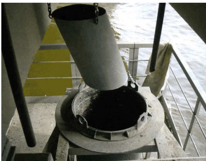
Рисунок 27 - Комбинированный фильтрующий патрон (установка на опоре моста)
