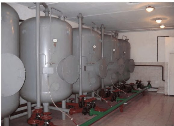
Рисунок 18 - Очистное сооружение индивидуального проектирования (фильтры 1-3 ступеней очистки)
