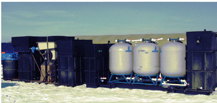
Рисунок 2.6.1. Общий вид установки очистки технических вод и стоков ЭХО-К-3
