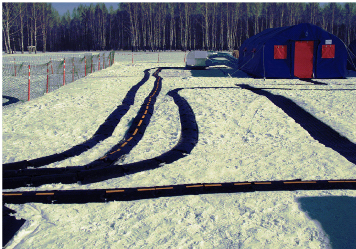
Рис. 2.3.3. Общий вид кабель-каналов системы энергоснабжения на территории ПВР
