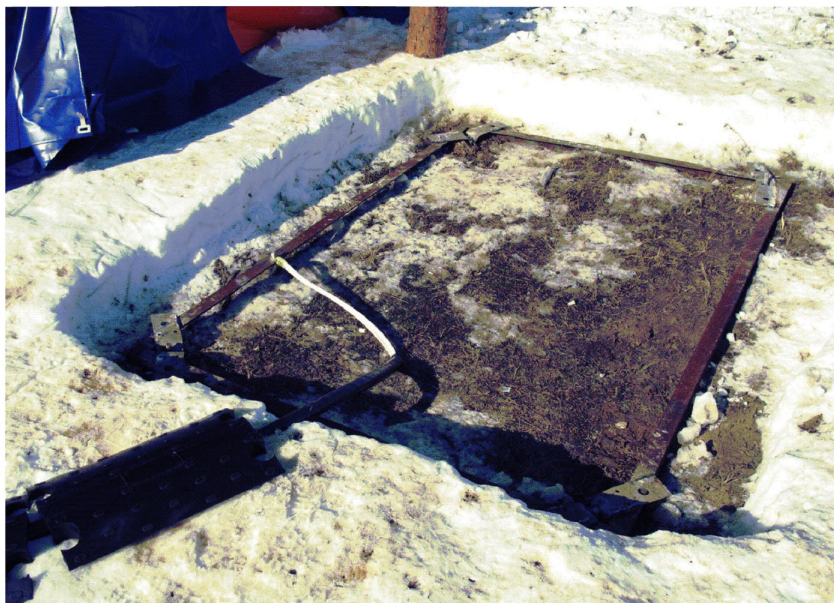
Рис. 2.3.6. Заземляющее устройство дизель-генераторной установки
