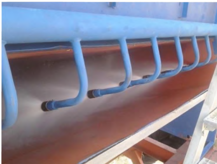
Рисунок 2.15 — Коллектор циркуляционной воды с форсунками эжекционной градирни 3)
