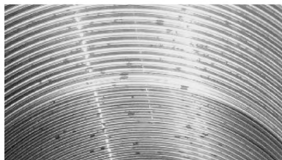
в) Следы коррозии на внутренней резьбе
