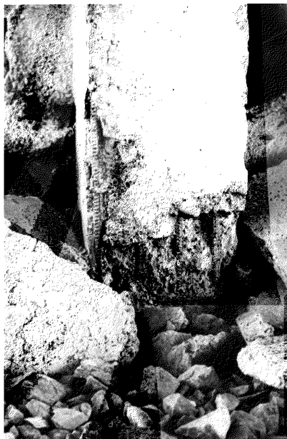
Рисунок М.1 – Повреждение стойки опоры автодорожного путепровода при землетрясении силой 9 баллов
