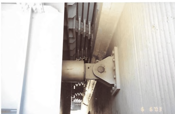
Рисунок 6.9 – Гидравлический демпфер, установленный между концом пролетного строения и шкафной стенкой устоя
