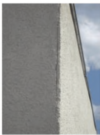
Д. Вертикальные трещины в штукатурном слое
