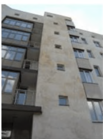
Ж. Повреждения штукатурных поверхностей на фасадах
