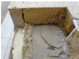
Е. Неплотное прилегание утеплителя к основанию
