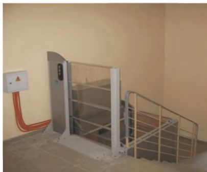
Верхняя площадка платформы вертикального перемещения
