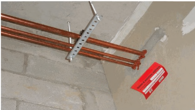
Рисунок 4 – Применение огнестойкого герметика для заделки места проходки трубопроводов медицинских газов в защитном футляре (гильзе)
