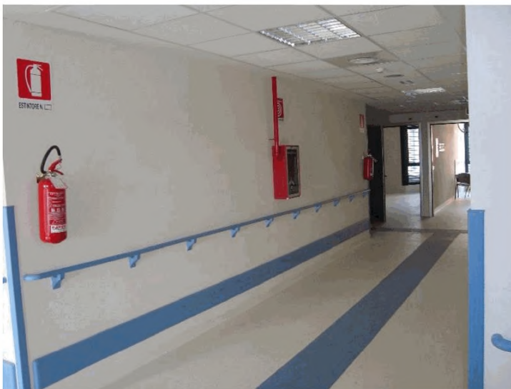
Рисунок 11 – Пример оборудования палатного отделения первичными средствами пожаротушения
