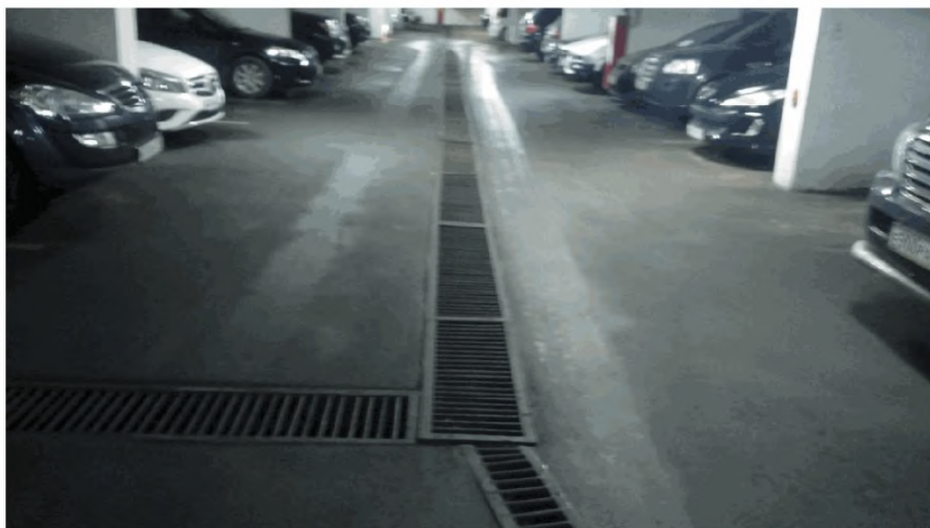
Рисунок 28 – Примеры устройства для отвода воды в случае тушения пожара в сеть ливневой канализации или на рельеф
