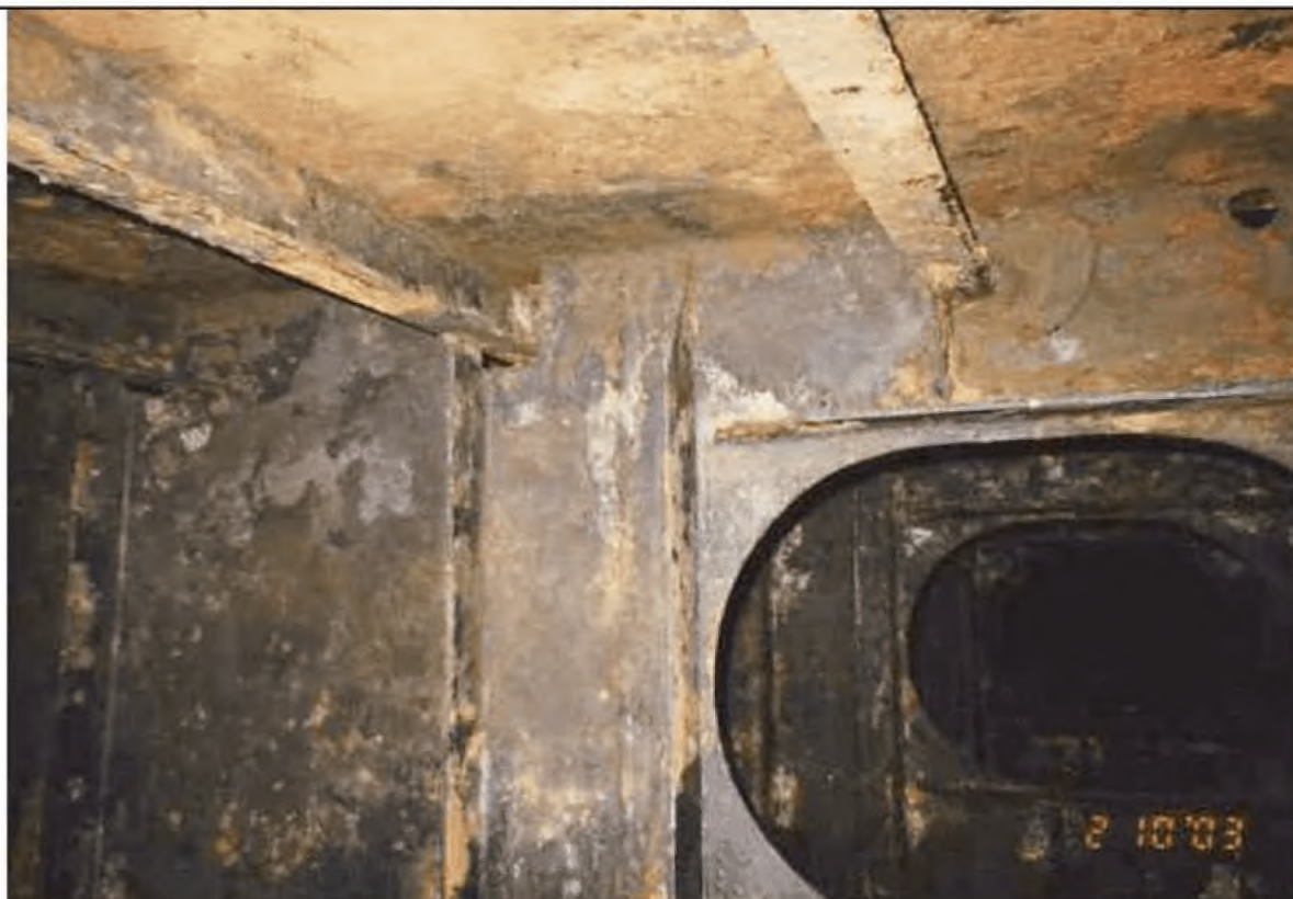
ПЛОХОЕ СОСТОЯНИЕ ПОКРЫТИЯ
