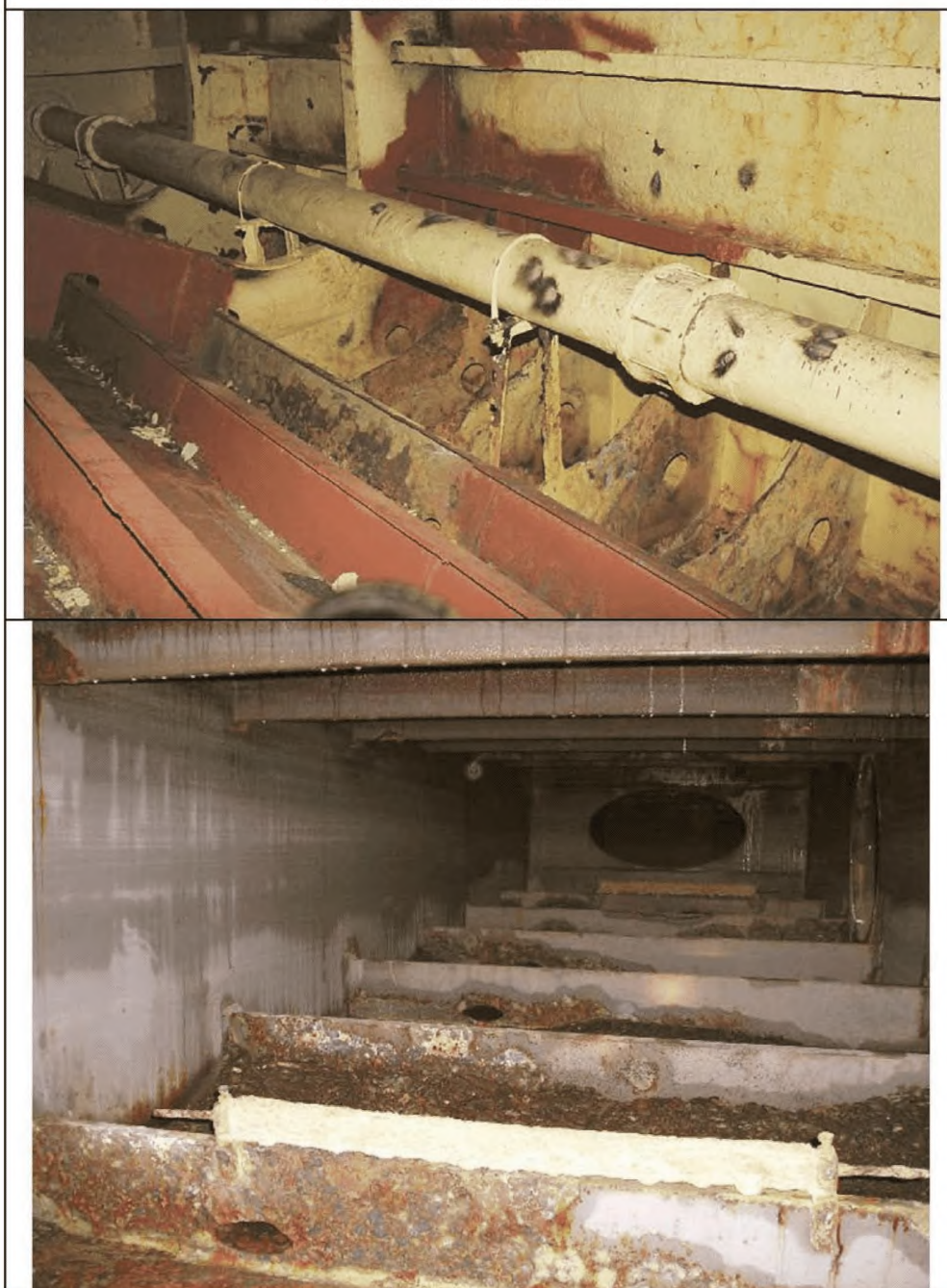
ПЛОХОЕ СОСТОЯНИЕ ПОКРЫТИЯ
