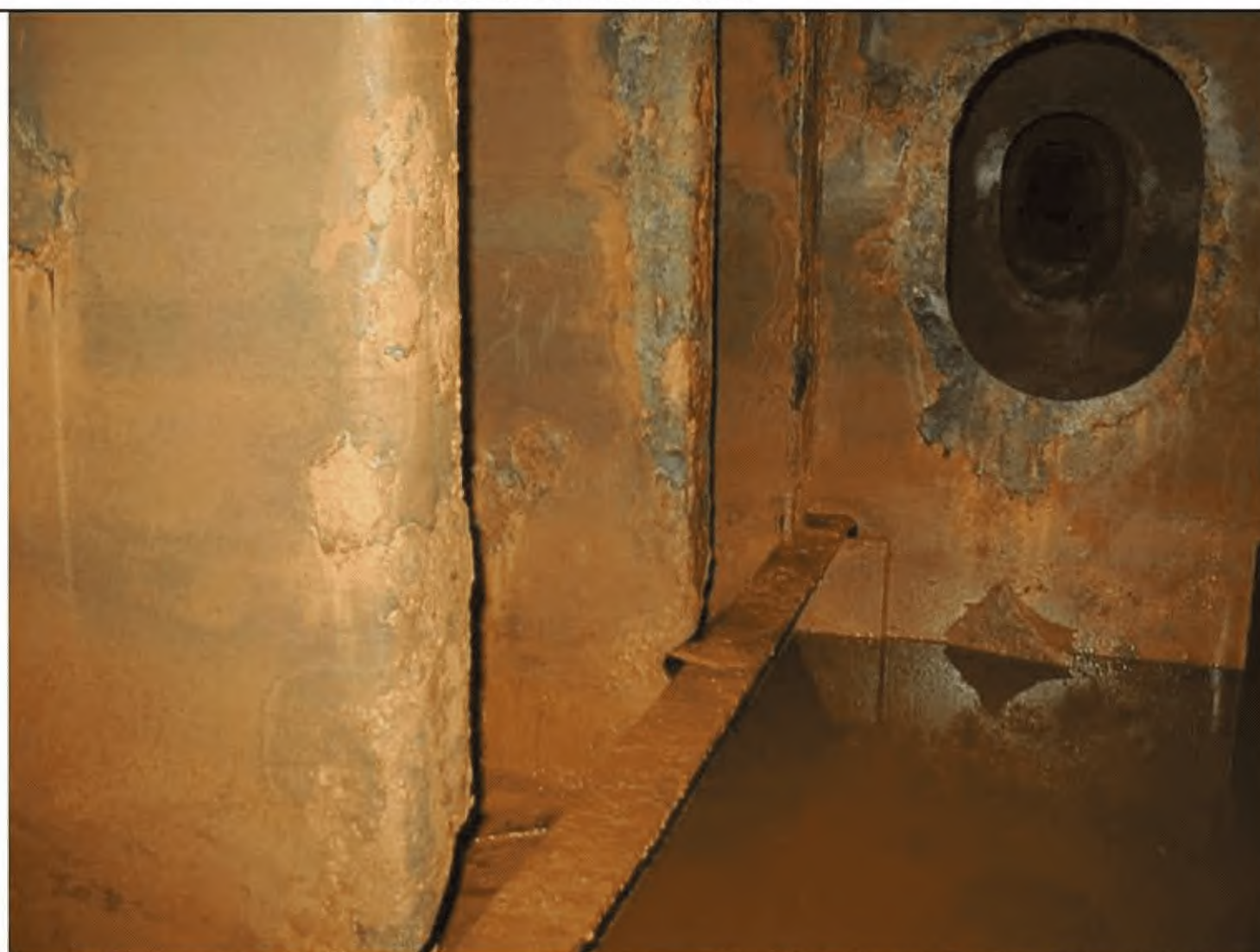
ПЛОХОЕ СОСТОЯНИЕ ПОКРЫТИЯ
