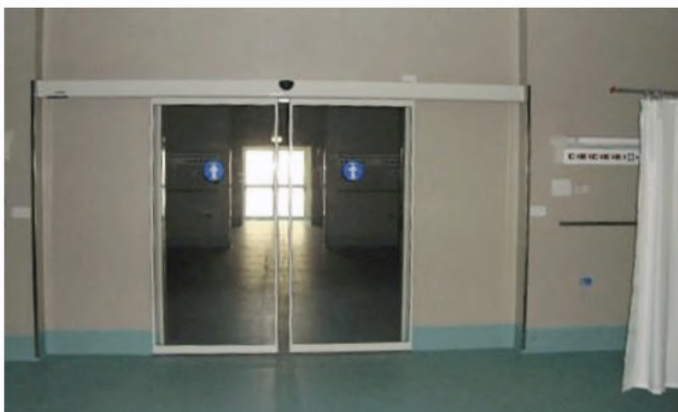
Рисунок 108 – Пример установки раздвижных дверей при входе в оперблок
