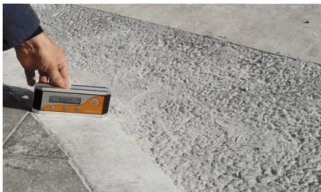
Рисунок 5.14 – Недопустимые конструкции съездов как по уклону, так и по расположению съезда на проезжей части
