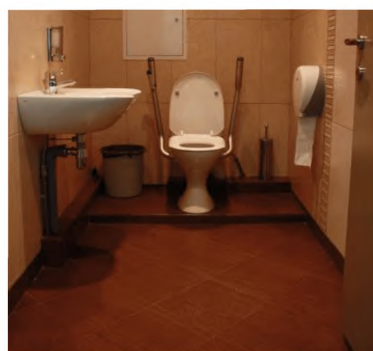
Зона рядом с унитазом для установки кресла-коляски не обеспечена
