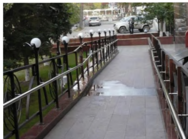
Водоотвод с пандуса не обеспечен
