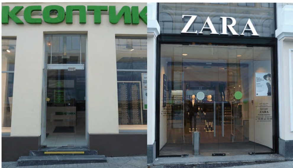
Отсутствие маркировки на стеклянных полотнах дверей недопустимо
