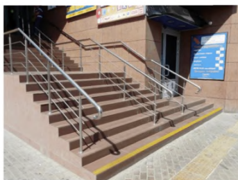
Недостаток: отсутствие горизонтальных завершений поручней
