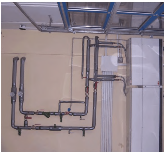
Рисунок 8 – Фрагмент установки воздушно-тепловой завесы
