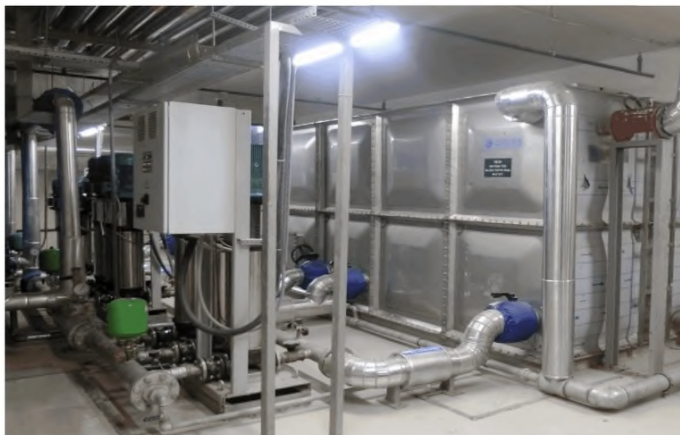
Рисунок 19 – Автоматическая станция пожаротушения с резервуарами воды
