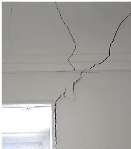
Рисунок 1 – Пример кладки с отдельными деформационными трещинами, проходящими по проему в стене и возникшими вследствие неравномерной осадки фундаментов
