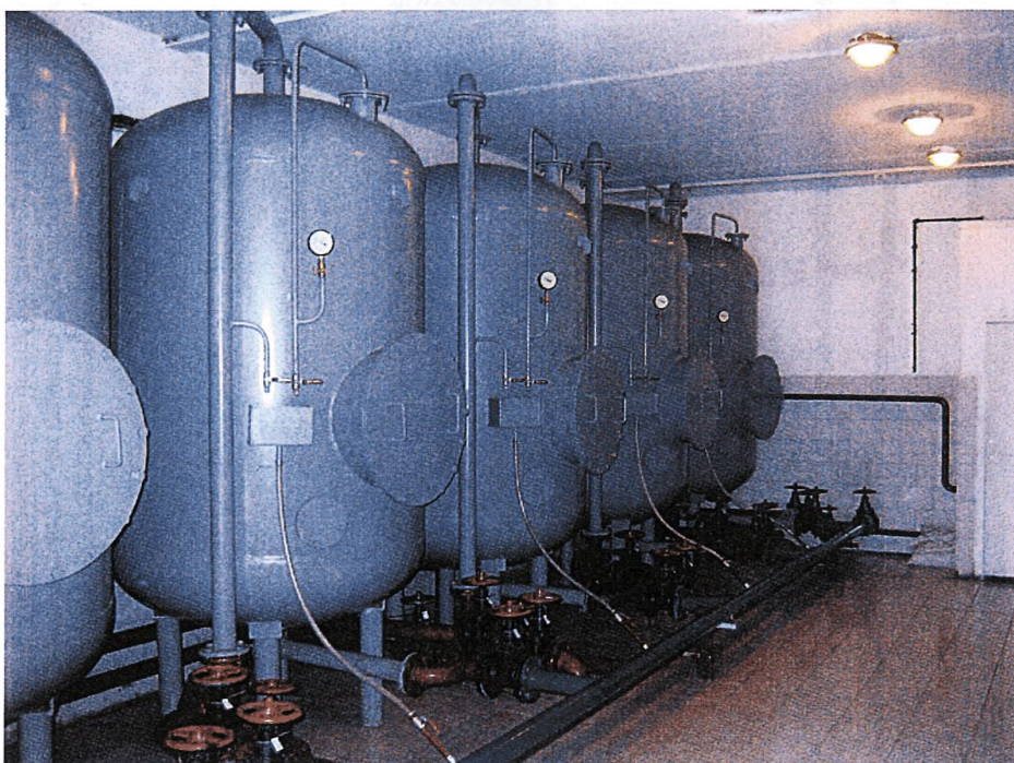
Рис.4.3.4. Очистное сооружение индивидуального проектирования (фильтры 1-3 ступеней очистки)
