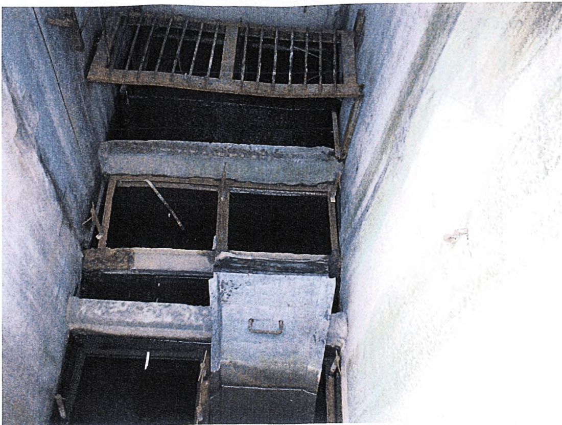
Рис. 4.6.4. Очистное сооружение индивидуального проектирования кассетного типа (секция очистки ливневых сточных вод)
