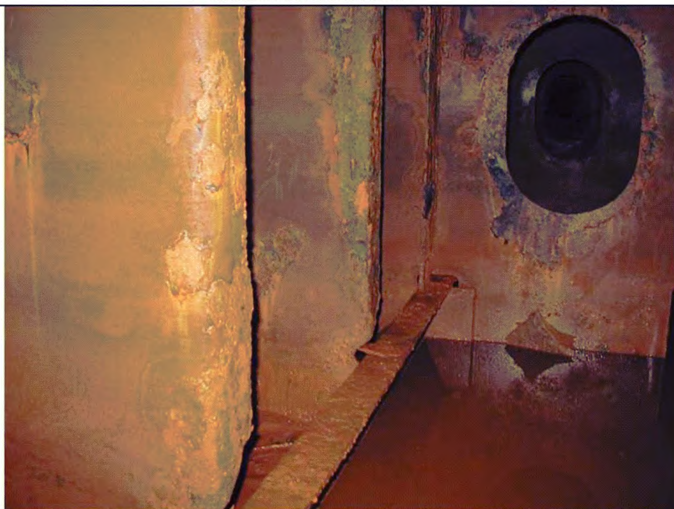
ПЛОХОЕ СОСТОЯНИЕ ПОКРЫТИЯ
