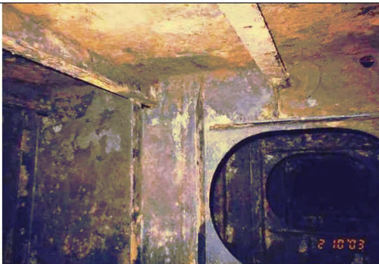
ПЛОХОЕ СОСТОЯНИЕ ПОКРЫТИЯ
