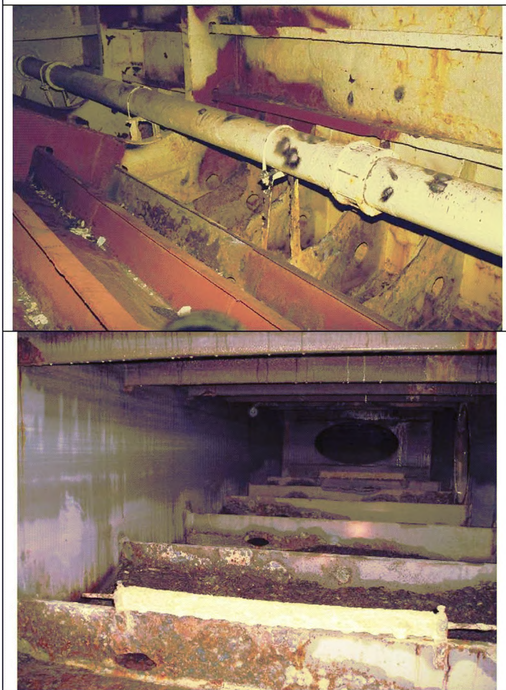
ПЛОХОЕ СОСТОЯНИЕ ПОКРЫТИЯ
