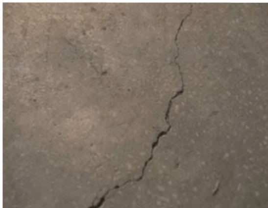
Рисунок 1 – Подвижная трещина. Общий вид
