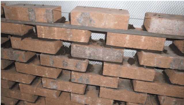
Рисунок Б.2 – «Перфорированная» кладка облицовочного слоя в наружной стене здания
