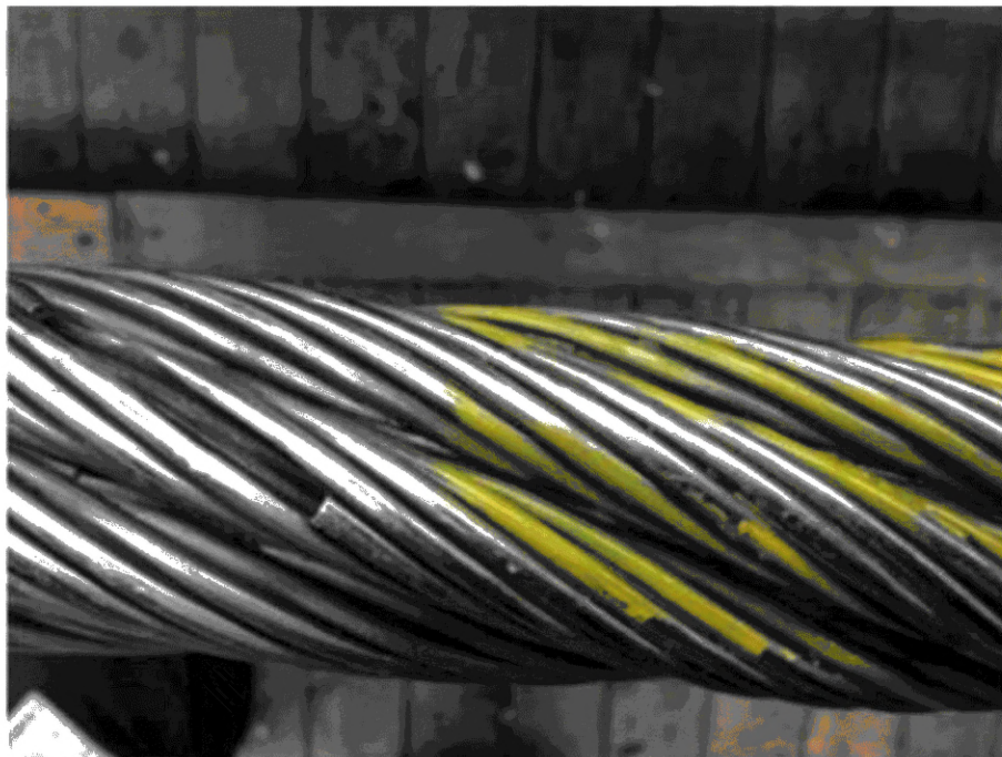
Рисунок А.1 — Обрывы наружных проволок несуще-тягового каната
